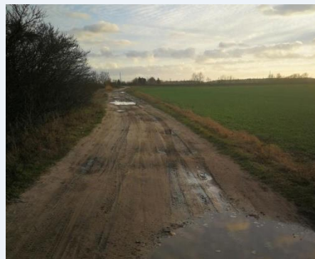
Blick 1: Blick in Richtung Süden, schlechter Zustand
